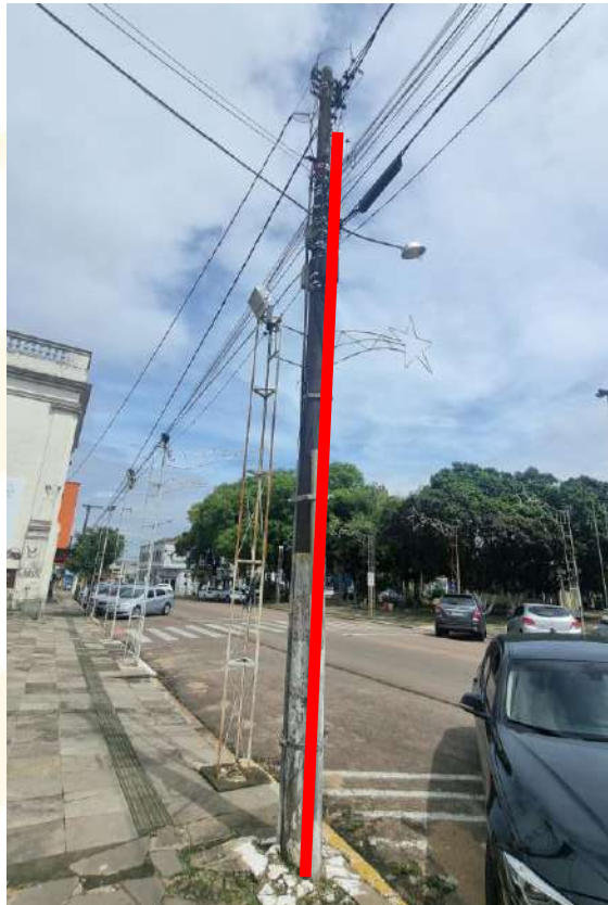
Figura 9: Ramal de ligação a substituir.
