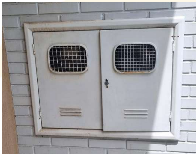
Figura 13: Foto da caixa de medição.
