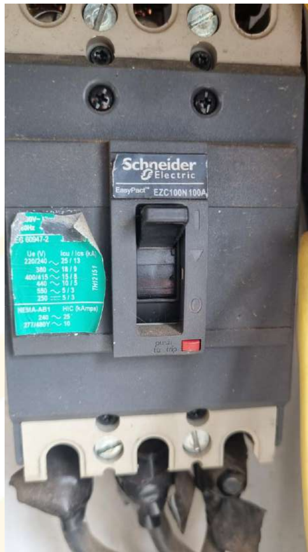
Figura 12: Disjuntor geral da UC
