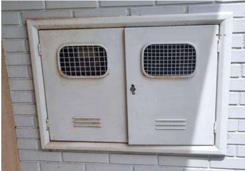
Figura 3: Foto da caixa de medição.
